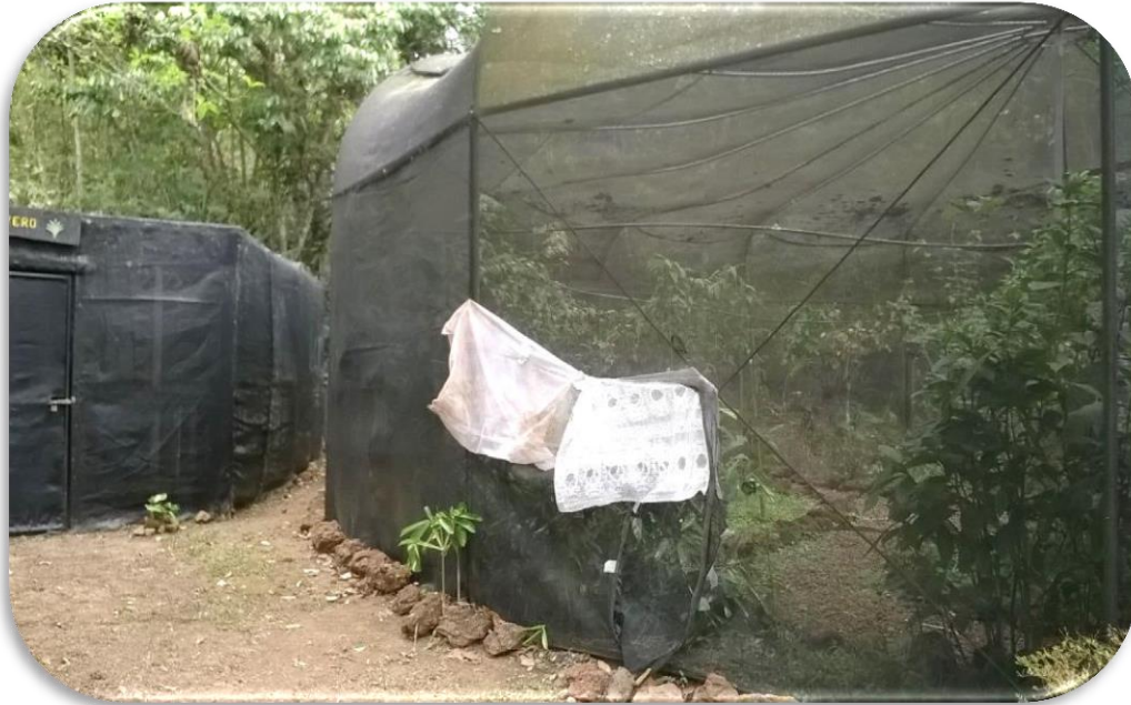
Figura 2. Mariposario, el cual tuvo que cubrirse con material provisional (tela blanca) en abertura provocada en acto de vandalismo.
